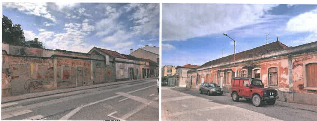
Figura 27. Edifícios degradadas na ARU do Pinhal Novo
